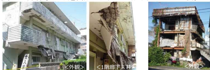
2階の廊下部分が崩落した事例
